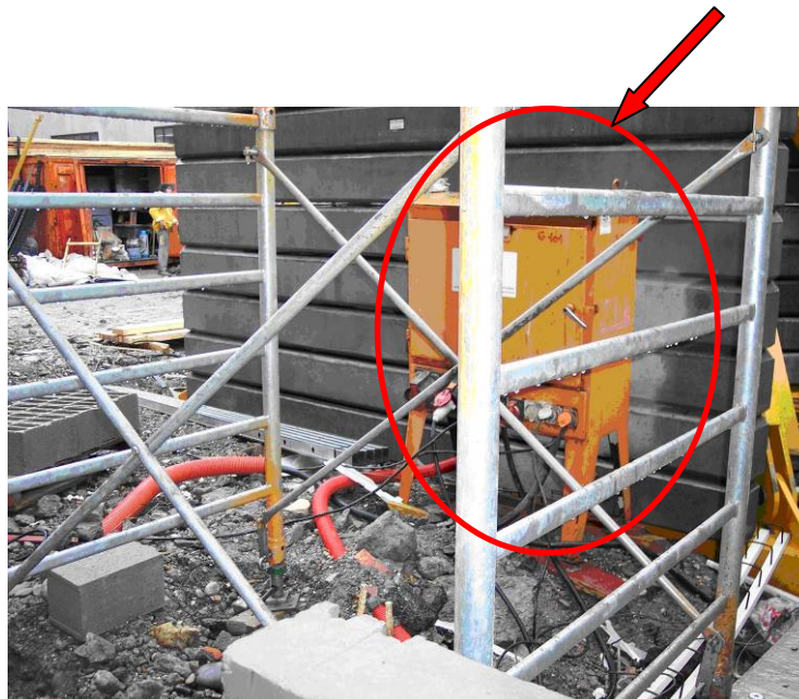
Transformateur de la grue
