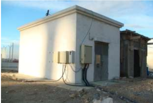
Poste MT/BT du Quai de Service
